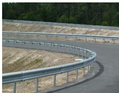
Barrières de sécurité
